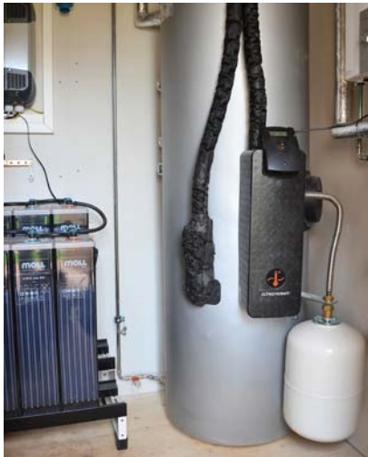
Das angebaute Technikmodul umfasst einen Warmwasserspeicher, den Wechselrichter mit Batterien, Gasdurchlauferhitzer usw. (Foto: Tanja Schindler)
